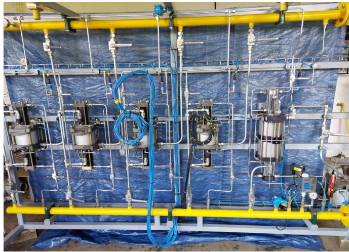
Układ doprężarek oferowany przez NGV AUTOGAS Sp. z o.o., zainstalowany w CERRAD Sp. z o.o.
